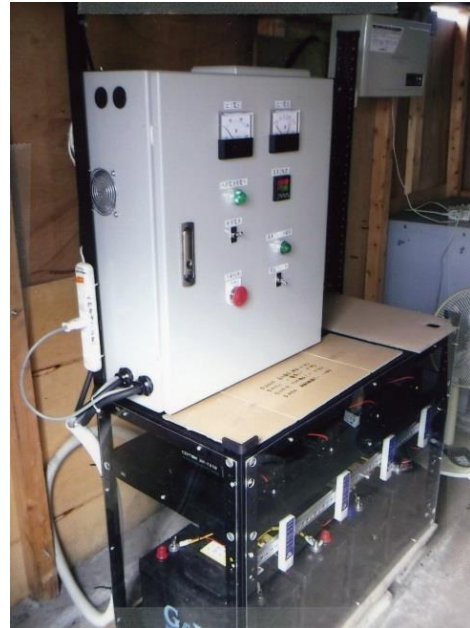
バッテリー、パワーコンディショナシステム
